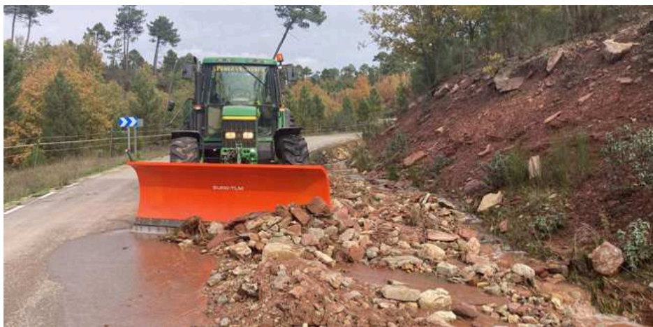
Labores de limpieza de la carretera de Ablanque (Guadalajara), tras la DANA del 29 de octubre
