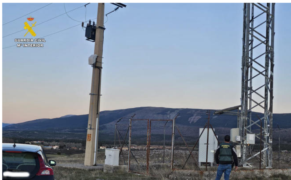
Imagen de un repetidor con los cables cortados
