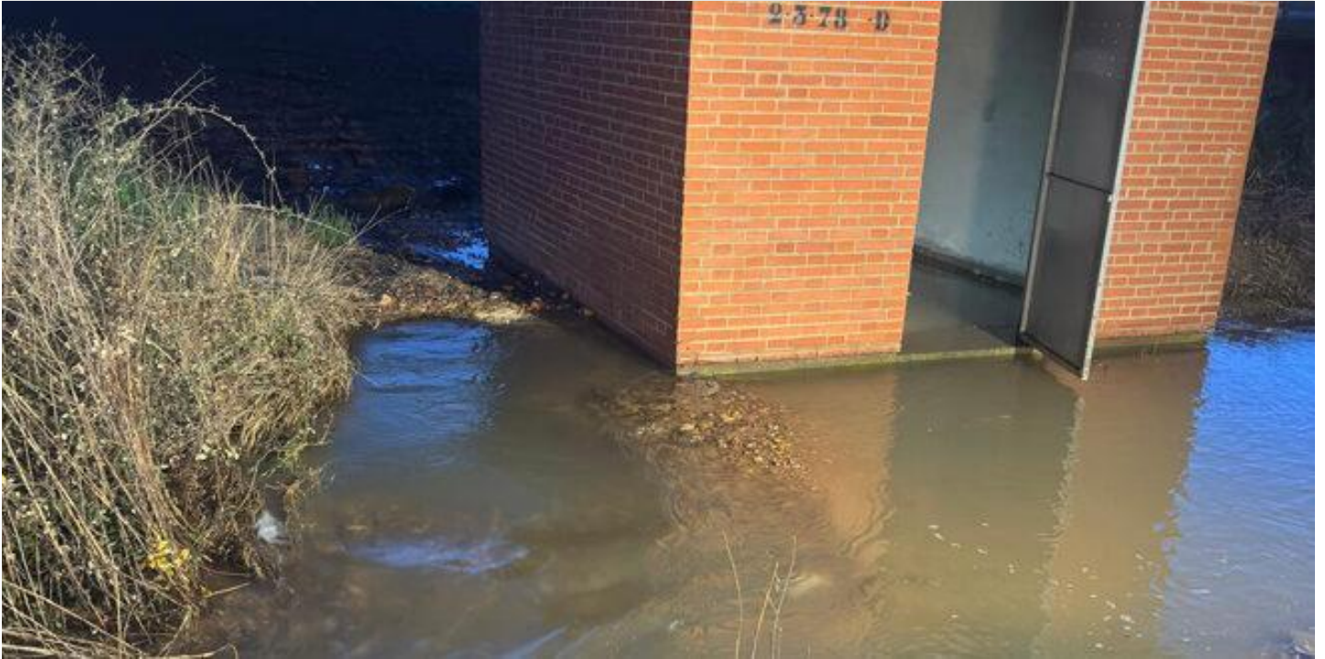
Imagen del embalsamiento de agua producido por la rotura de la conducción de la MAS a la altura de Yunquera de Henares
