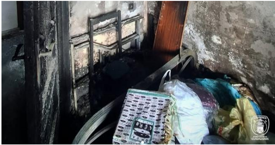
Estado en el que quedó el inmueble de los afectados. Fotografía de los bomberos del Ayuntamiento de Guadalajara
