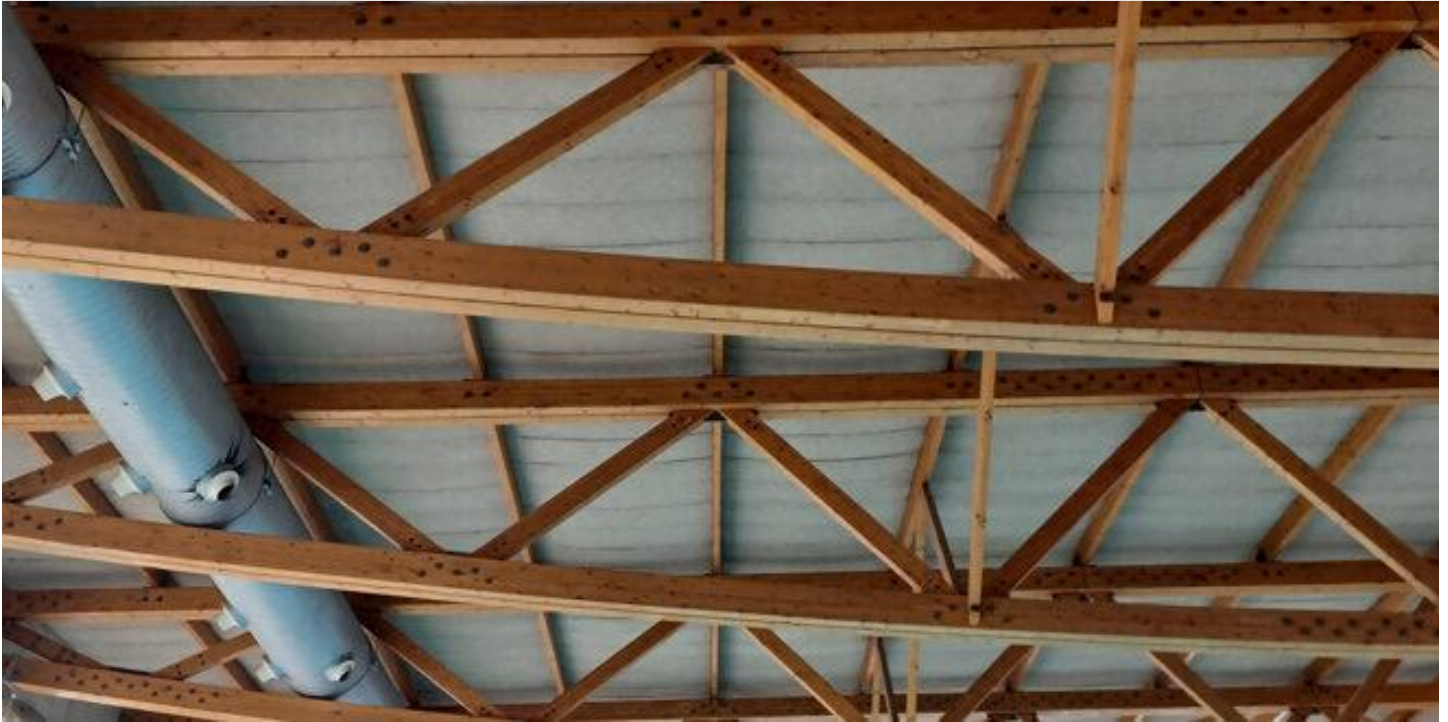
Cubierta en mal estado de la piscina cubierta del complejo municipal Fuente de la Niña, 'Sonia Reyes'
