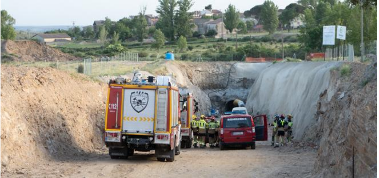
Imagen de los servicios de emergencias a la entrada de la mina Santa Catalina, en Hiendelaencina, tras el derrumbe que dejó atrapados a dos trabajadores. Fotografía de la Diputación de Guadalajara
