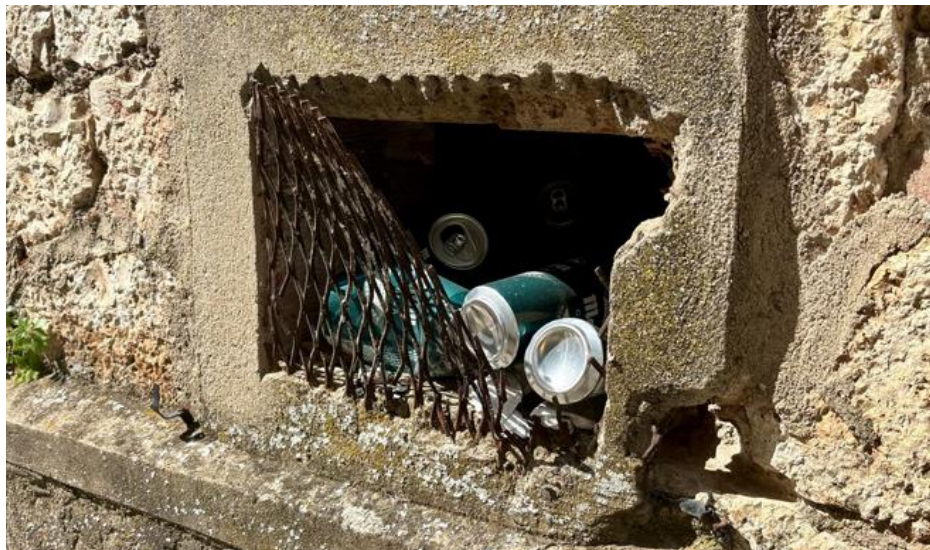
Deterioro del complejo de El Fuerte de San Francisco. Fotografía de Cuka Leyre
