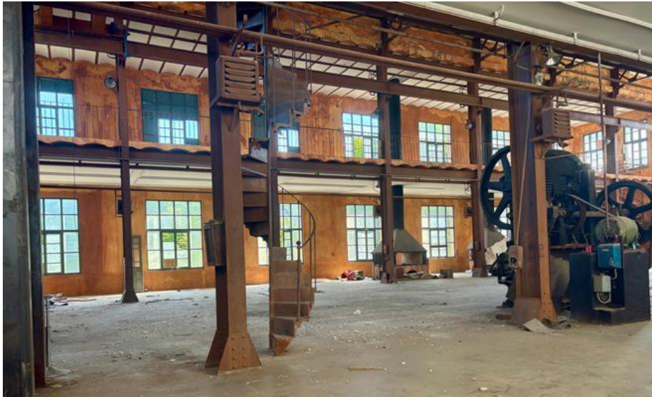
Interior de la nave de forja derruida del Fuerte de San Francisco.
