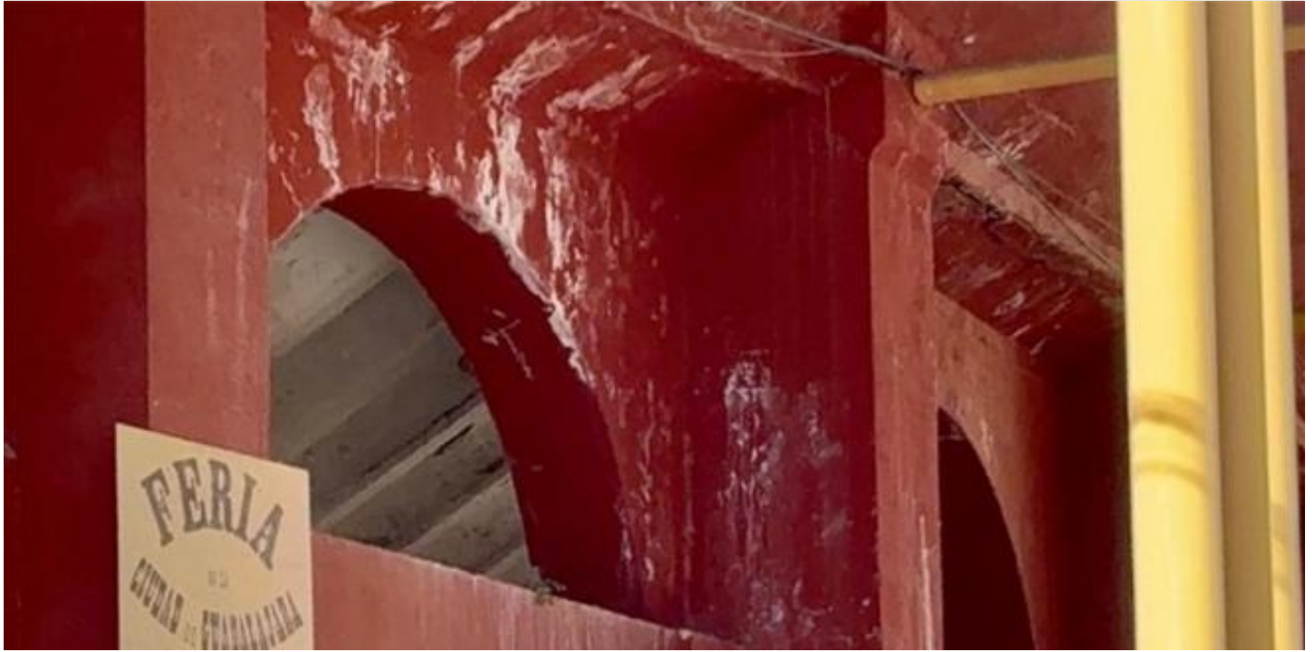
Estado de la fachada de la plaza de toros de Guadalajara. Fotografía de Cuka Leyre
