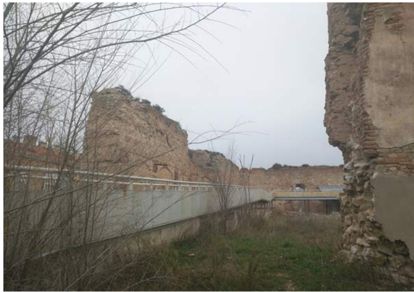
Imagen de archivo del estado de deterioro del interior del recinto
